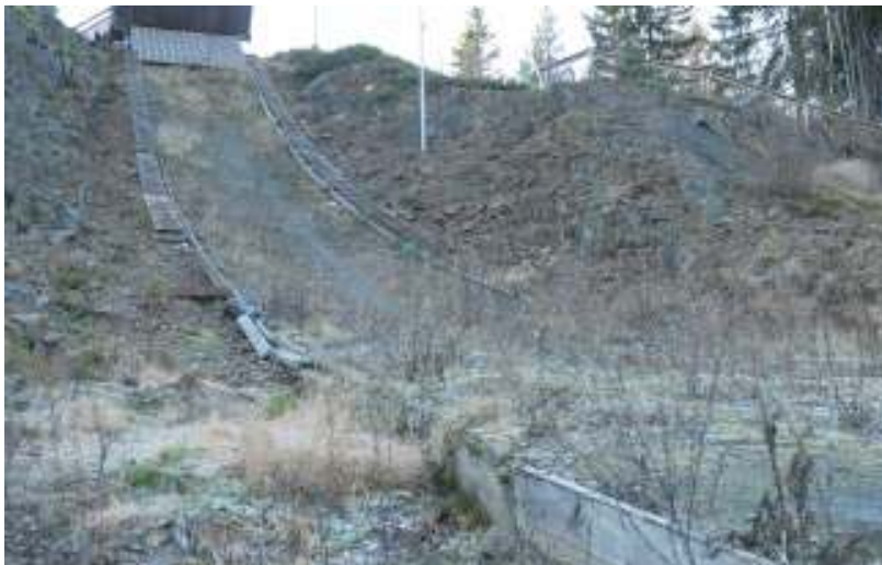
Preppevangene var falt sammen, råtnet og smuldret opp.
