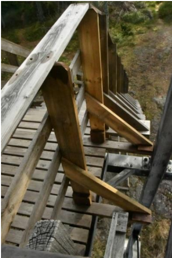
Rekkverk på repos fra adkomsttrapp til langtrappen, Foto Cany Bygg
