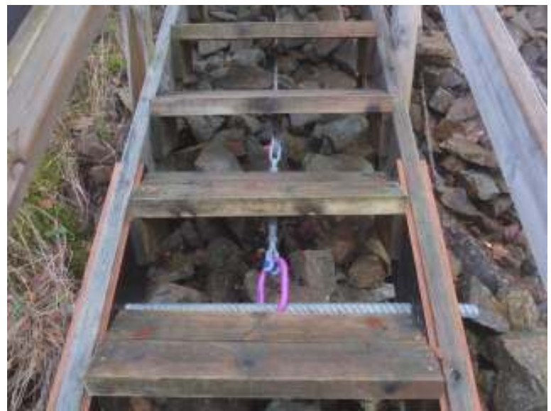
Nordre måletrapp. Innfesting av wire til med strekkfisk og toppløkke til stålstang gjennom forsterkede vanger
